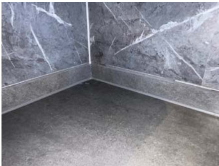
Ujevne glipper mellom sokkelflis og våtromsplater.
