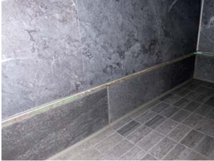
Sprukket silikonfuge mellom sokkelflis og bunnlister.
