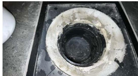
Sluk under servantinnredning
