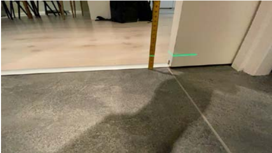
Høydeforskjell (flis ved terskel)
