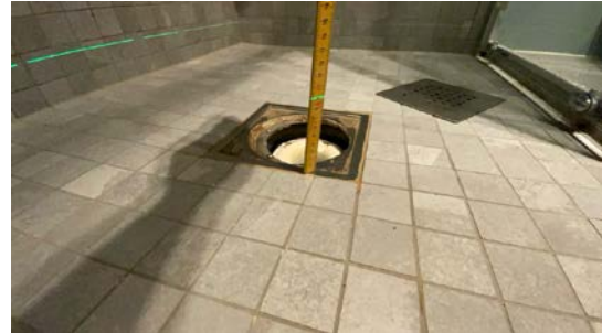
Høydeforskjell (ved sluk i dusjsonen)
