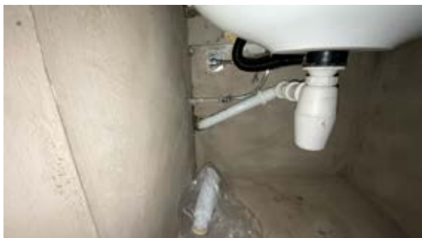
Ikke synlige rørmassjetter ved rørgjennomføringer i vegg under innredning.
