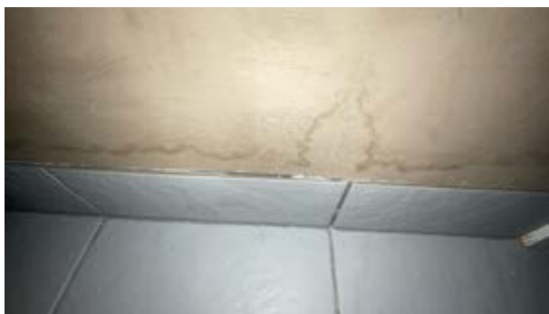
Synlige vertikale skjøter, ikke dokumentert hvilken type bygningsplater som er benyttet. Fiberpuss er ikke godkjent som endelig tettesjikt.
