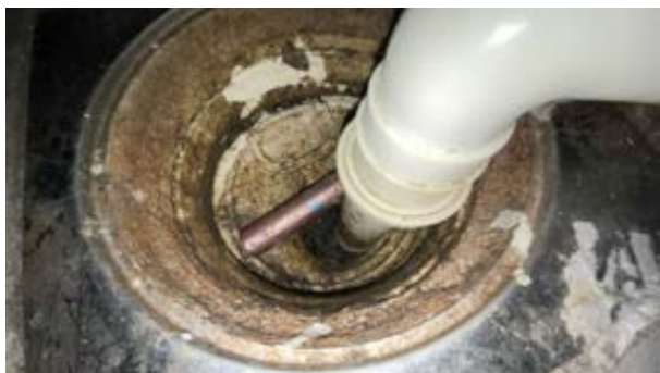
Sluk under dusjkabinett.
