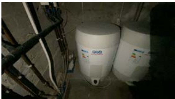
Varmtvannstank i felles teknisk rom.
