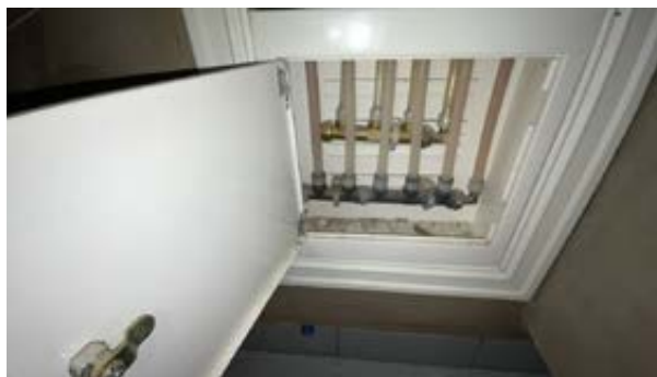
Rør i rør sentral
