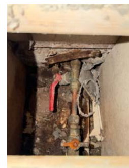
Stoppekrane er plassert i gulv på bad i underetasjen.
