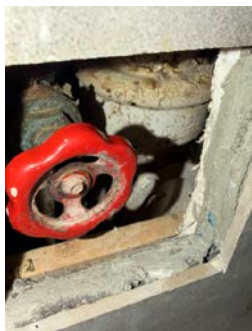
Stoppekran er plassert i vegg på bad i underetasjen.
