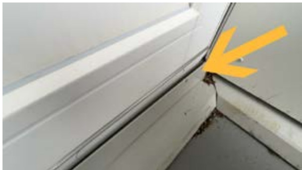
Beslag har løsnet i nedre kant av balkongdøren.
