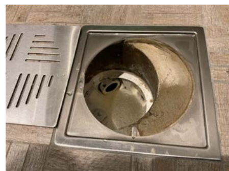
Sluk, tykk påstøp over sluken.
