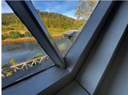
Kondensvann på innsiden av glasset.
