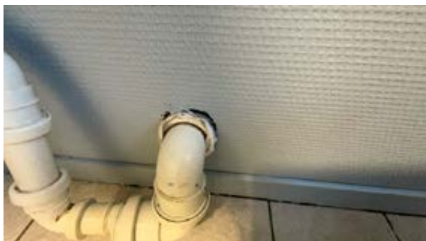
Utett overgang mellom rør og vegg
