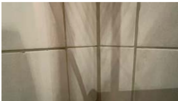
Flisfuge i dusjonen.
