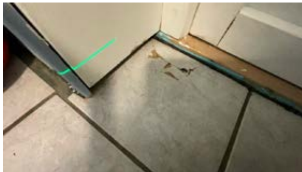
Sprekker i flis.
