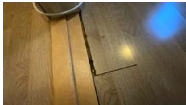
Dårlig avslutning på parkett.
