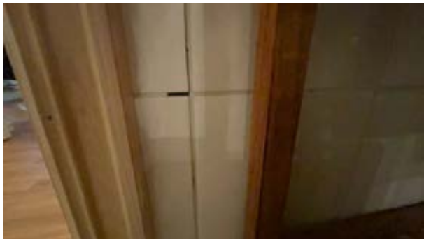
Flisfuge ved døren.
