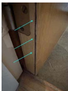
Delaminering av baderomsdøren.
