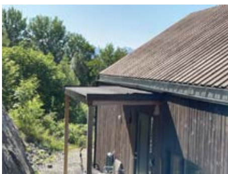
Mangler beslag mot vindskibord på takrenne på overbygg ved inngang
