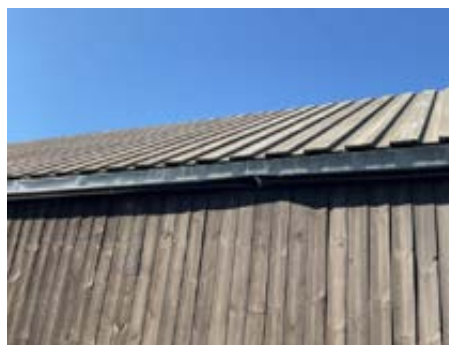
Skade/bulk i takrenne på baksiden av hytten
