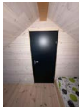
Dør på hems. Mangler lister rundt dør. Se pkt. overflater hvor dette er anmerket
