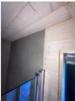
Mangler lister ved overgang panel og flis
