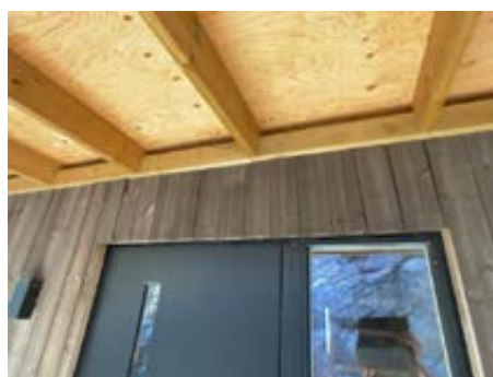
Kledning over inngangsdør er ikke festet i toppen mot takoverbygg slik at kledningen ikke står i lodd
