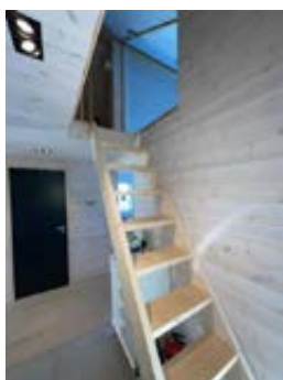
Mangler rekkverk ned langs trapp
