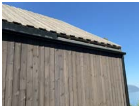
Mangler bortakbeslag på øvre bakre hjørne
