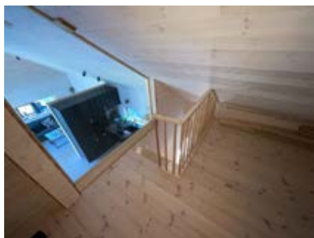
Noe svakt og for lavt rekkverk
