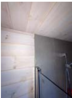
Mangler lister ved overgang panel og flis
