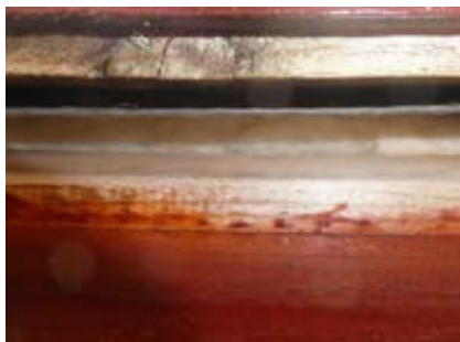
Åpninger bak kledning
