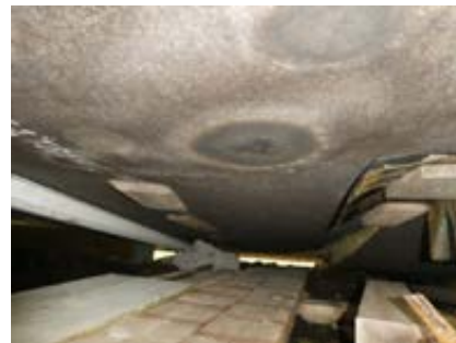
Stubbeloft under tilbygg soverom. Løse stubbelofts plater og tydelig tegn på mus/skadedyr.
