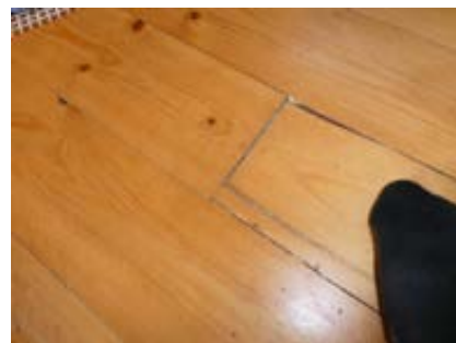
Gulvbord ved kjøkkeninnredning har nedbøy
