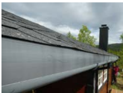
Plast takrenner og nedløp
