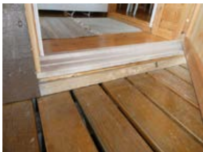
Beslag under balkongdør er ikke etablert.
