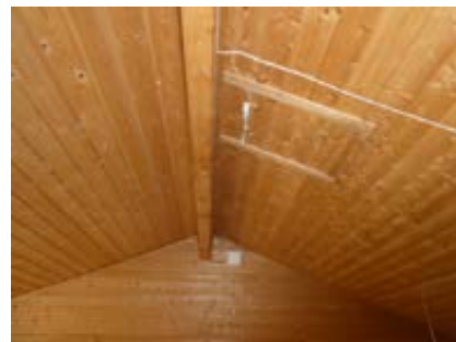
"sår" i himling etter tidligere pipe
