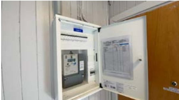
Sikringskap plassert i felles gang/trappeoppgang.
