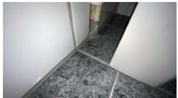
Ikke synlig rørmansjett.
