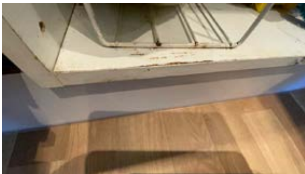
Mindre brukmerke på skap under oppvaskkum.
