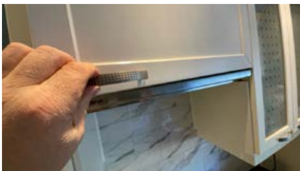
Skapdør over ventilator må justeres.
