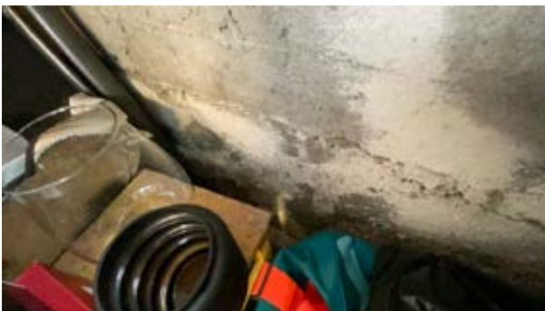
Salt/kalkutslag på vegg mot grunn i kjeller (felles areal).
