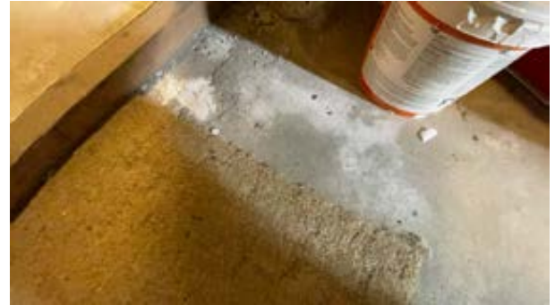
Salt/kalkutslag på gulv mot grunn i kjeller (felles areal).
