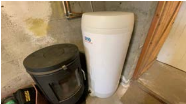
Varmtvannsbereder i kjellerbod.
