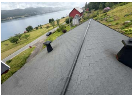
Oversiktsbilde, takflate mot nord helt ved takfot har noe mosedannelse.
