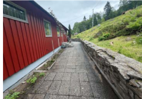
Store skjevheter i støttemur på baksiden av boligen etter markpress.
