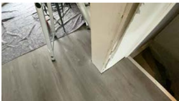
Sår skader ved avslutning vegg.
