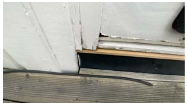
Svellskader på balkongdør mot vest.
