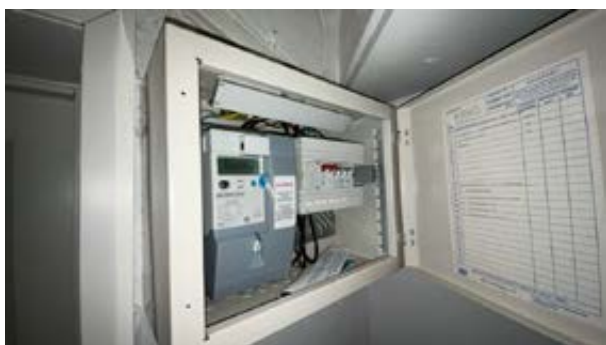
Sikringskap med egen teller for felles brannvarslingsanlegg.
