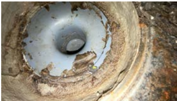
Sluk under dusjkabinett.
