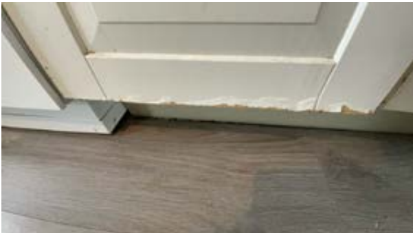
Fuktskader på to fronter.
