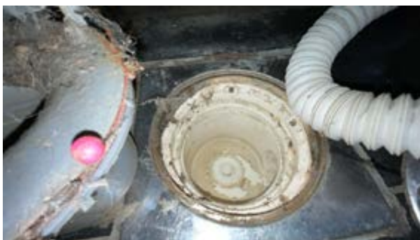
Plastsluk hvor utforming ikke viser klemring/tettesjikt.
