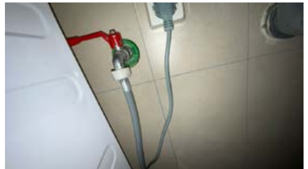
Manglende fuging/rørmansjett ved rørgjennomføring i vegg under innredning.
