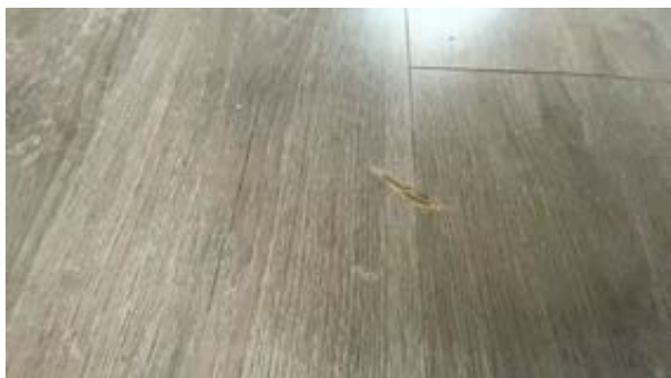
Sår/skade i stue/kjøkkengulv.
