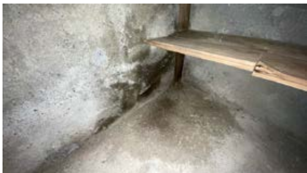
Visuelle tegn på fuktvandring mot grunn.
