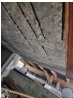
Korrosjon og rustspreng i underliggende betongdekke.
