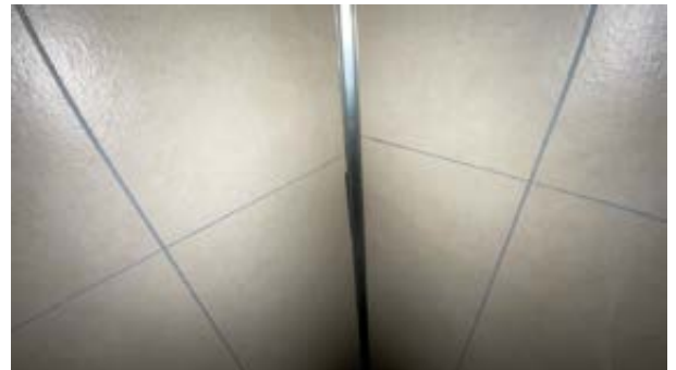
Ikke fagmessig montering av baderomsplater.
