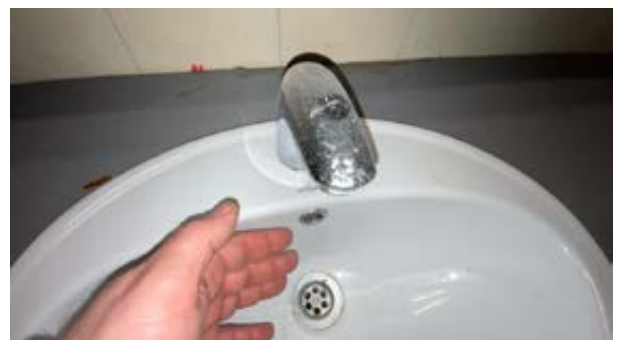
Berøringsfritt armatur fungerte ikke ved befarig.
