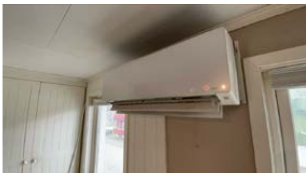
Innvendig luft til luft varmepumpe.
