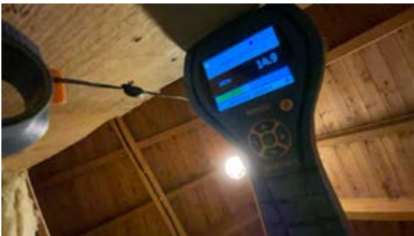
Det ble målt 14,9 vekt% fukt i takkonstruksjonen ved bruk av piggmåling.
