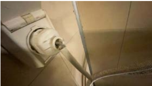
Skade på ledning/manglende jording.
