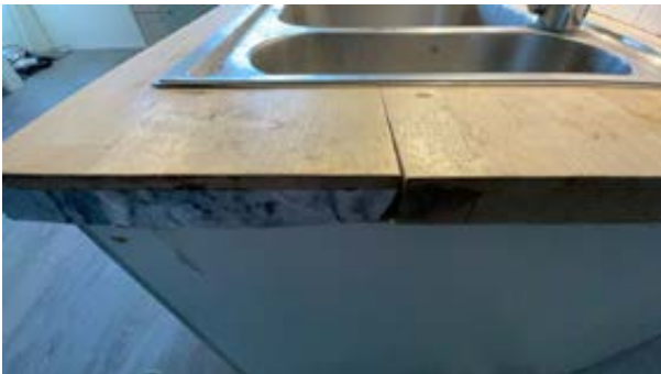
Sprekk i benkeplate ved vask.
