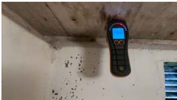
Høyt fuktnivå i trebod i tak i den mindre krypjkjelleren mot nord
