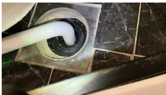
Sluk bad 1. etasje
