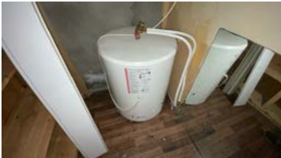
Varmtvannsbereider for leilighet i sokkel
