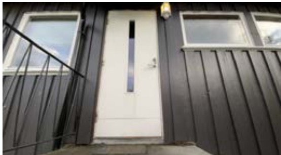
Inngangsdør til hovedenhet.
