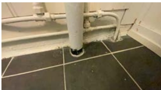
Ikke fagmessig/dokumentert tetting ved rørgjennomføring i gulv.
