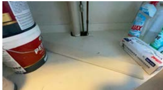
Svellskader i bunn av skrog under oppvask,
