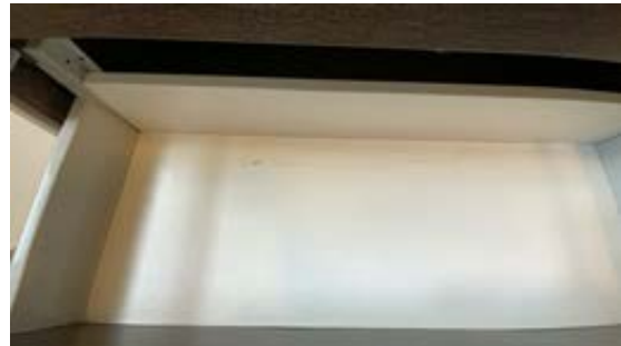
Skader/deformasjon i bunn av skuffer under vask.
