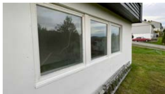
Punkterte vinduer i stue/kjøkken leilighet i sokkeletasje.
