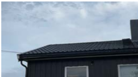
Manglende snøfangere i gangareal.
