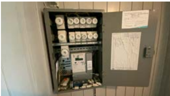
Sikringsskap i leilighet i sokkeletasje
