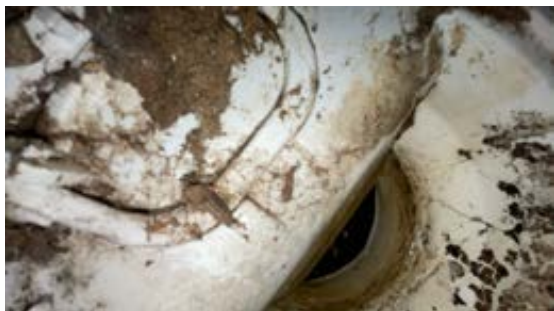
Sluk under dusjkabinett.
