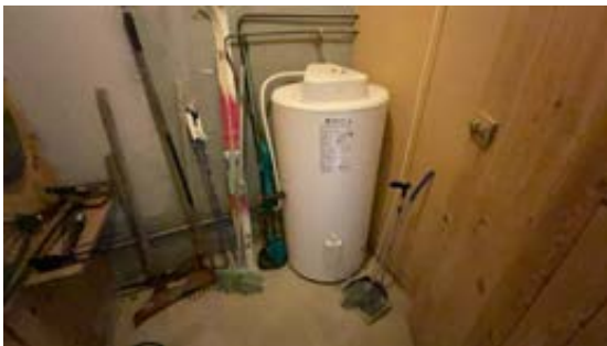
Varmtvannsbereider til hovedenhet plassert i bod sokkeletasje.
