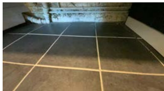
Ikke fagmessig/dokumentert tetting ved rørgjennomføring i gulv under innredning..
