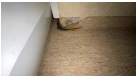
Tegn på ufagmessig tekking/skjøting ved utvendig hjørne på sokkel.
