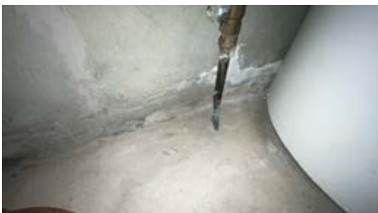
Salt/kalkutslag i nedre del av grunnmur mot syd, indikerer fuktvandring gjennom grunnmur.
