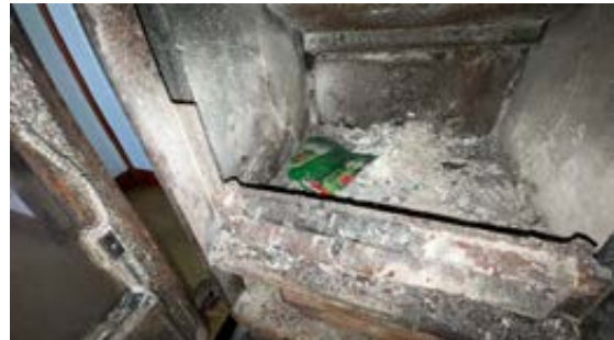
Sprekker i ildfast stein i vedovn i sokkeletasje.
