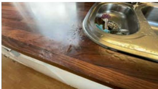
Svellskader i benkeplate ved oppvaskum,
