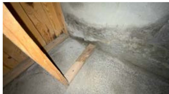
Salt/kalkutslag i nedre del av grunnmur mot syd, indikerer fuktvandring gjennom grunnmur.
