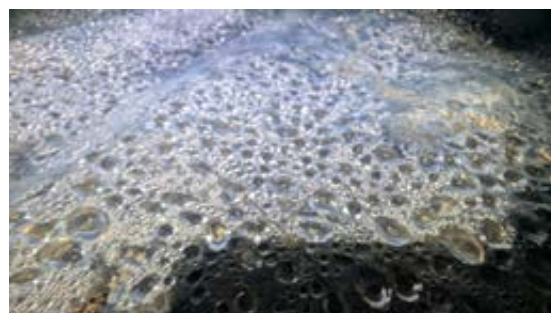
Fuktighet under plast.
