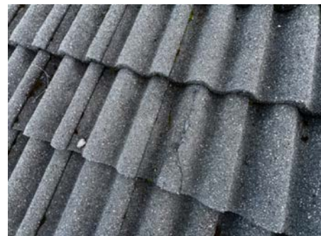
Eksempel på sprukket takstein.
