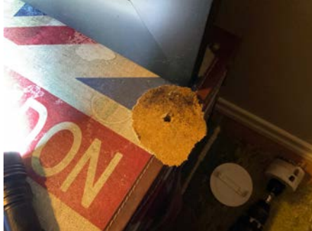
Synlig fukt på veggplaten mot soverom.
