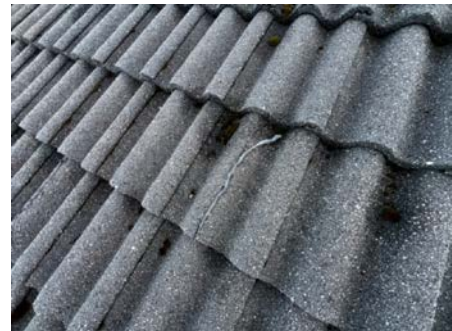
Eksempel på sprukket takstein.
