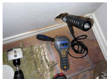
Hulltaking og fuktsøk. Fuktskader i vegggen.
