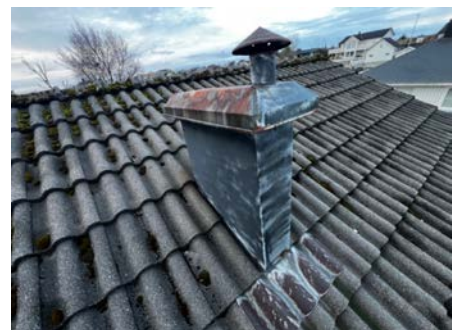
Ved luftehatten er det utslag på fukt i undertaket, ingen synlige lekkasjepunkt, kan være forårsaket av kondens.
