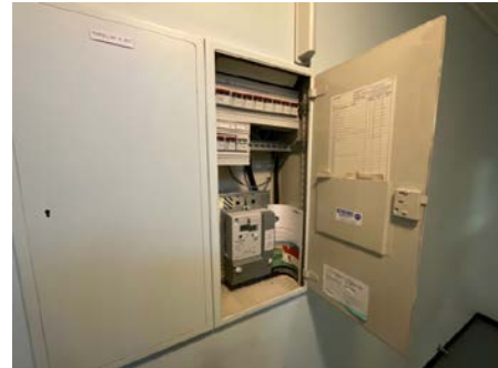
Sikringsskap plassert i felles trappegang.
