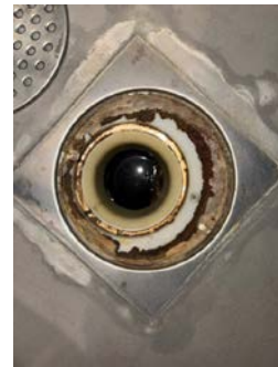
Eldre sluk. Misfarging på mikrosementen rundt slukristen.
