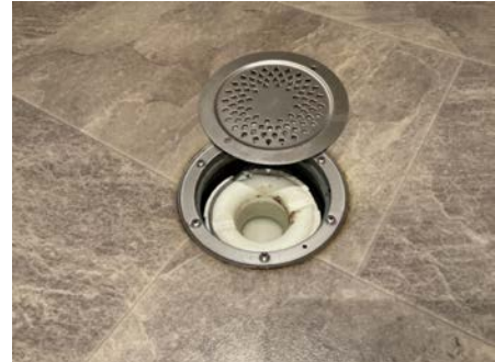
Sluk i dusjsone.
