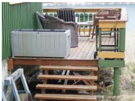
Trapp mangler rekkverk. Altan til venstre for trappa - mangler rekkverk.
