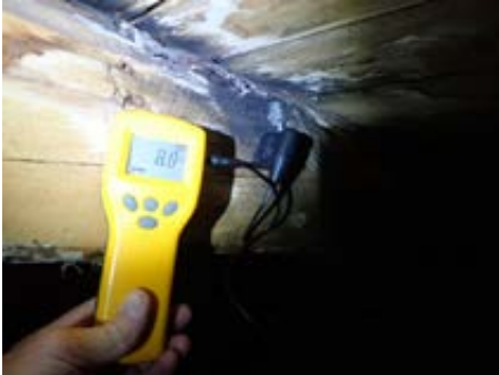
Fuktskadede sperre - Ca. 9% fukt - betegnes som tørt
