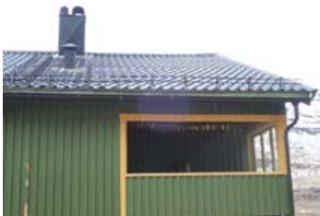
Spillblikk mangler under nytt taktekke.
