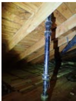
Soil rør for avlufting av kloakk over tak
