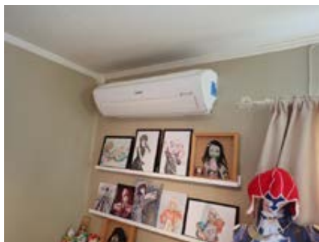
Varmepumpe luft til luft, montert ny i 2020.
