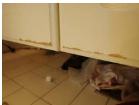
Fukt/vannskader i innrednings dørene
