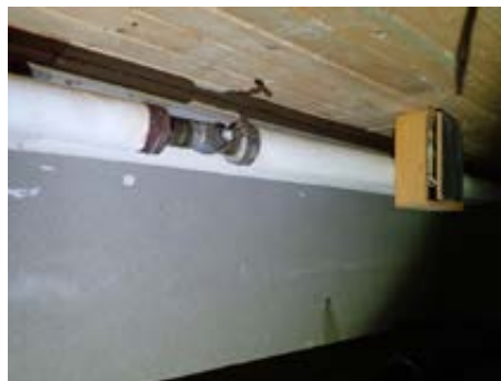
Stoppekran fra byggeår.
