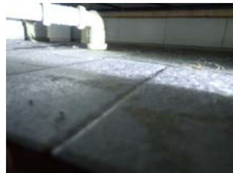
Rom under dusjkabinett. Direkte avløp via rør gjennom gulvet
