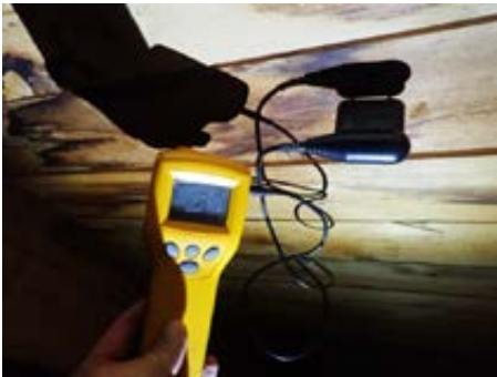
Ca 8 % fukt i trobordene - betegnes som tørt
