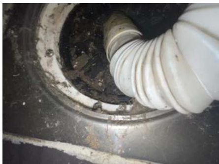
Sluk under dusjkabinett.
