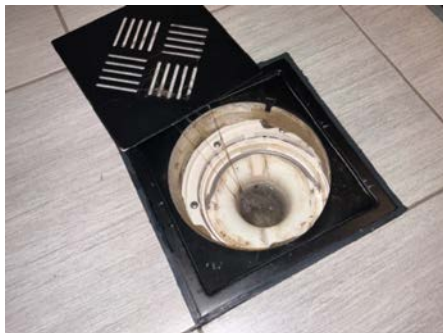
Sluk i dusjsone.
