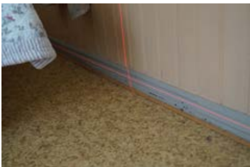
Gulv/etasjeskille har skjevheter
