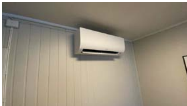
Luft til luft varmepumpe
