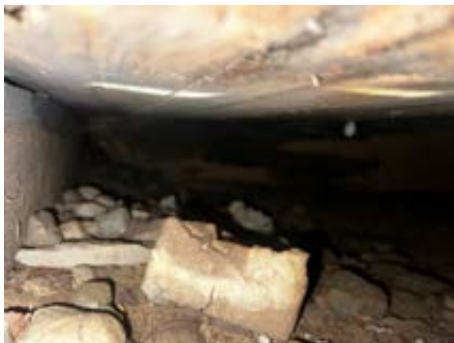
Fukt og råteskadet tilfarergulv i tilbygg. Lagt rett på støpt betongplate uten fuktsikring.
