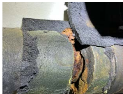
Rust/korrosjon på vannrør.
