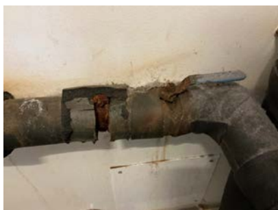
Rust/korrosjon på vannkran.
