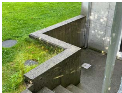
Rekkverk på støtte-mur til inngang ved kjeller er ikke etablert.
