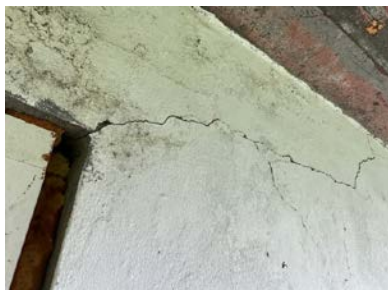
Sprekk i grunnmur.
