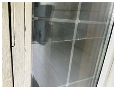
Sprekk i glassfelt ved siden av døren.
