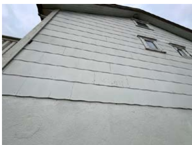
Eternittplater på vegg og det er begrenset lufting i underkant av disse.
