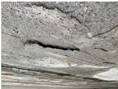
Avskalling i betongen fra undersiden av verandaen.
