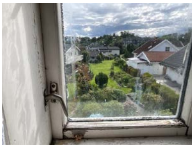
Tegn til kondens på vinduet innvendig og det er tydelige skader i karmen.
