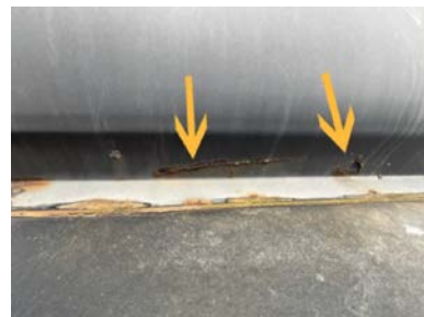
Det er sprekker i pipebeslaget.
