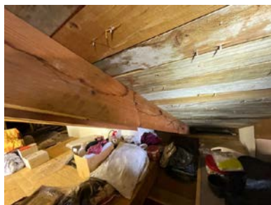
Fuktskjolder langs takspærre/ overgurt.
