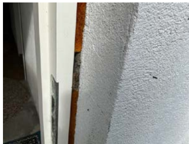
Ytterdør inn til underetasjen mot øst er ikke ferdigstilt.
