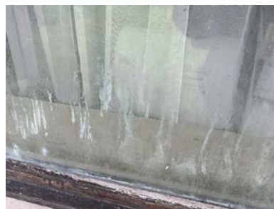
De eldste vinduene fremstår som svært slitte og det er observert punkterte vinduer.
