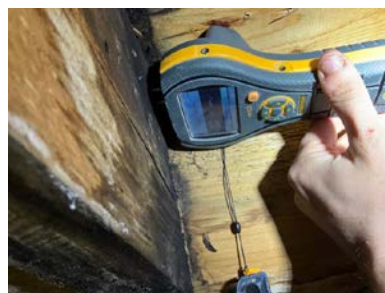
Fuktskjolde ved pipen.
