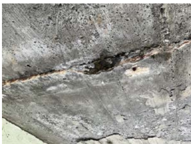
Fukt observert fra undersiden av verandaen.
