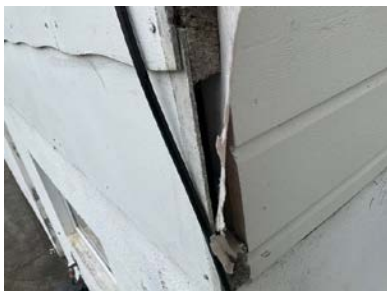
Hjørne er ikke ferdigstilt.
