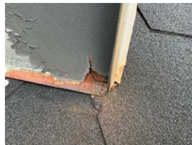
Sprekk og rust i nedre del av pipebeslaget.
