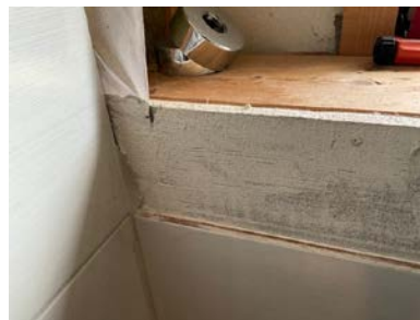
Tettesjiktet er ikke fullført. Dette er til høyre for dusj, ut mot vinduet.
