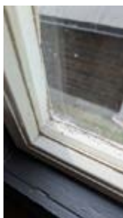
Vinduene i hytta har kort gjenværende levetid.
