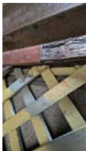
Fuktskadet tømmer sett fra utsiden under terrassen.
