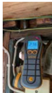
Fuktskadet tømmer sett fra innen/undersiden.
