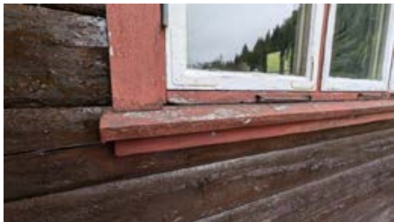
Vinduene i hytta har kort gjenværende levetid.
