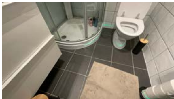
Begrenset tilkomst til sluk under dusjkabinett.
