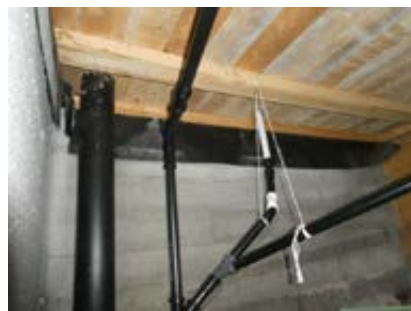
Uegnet materialer og Ikke fagmessig utført
