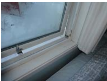
Vindu med punktert glass
