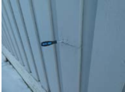
Råteskade i skjøte på kledning
