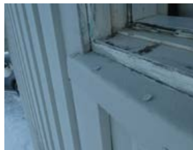
Utvendig tetting ikke helt fagmessig utført
