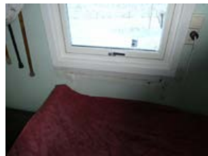
Gammel fuktskade under vindu på soverom sør side
