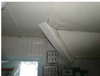
Gammel fuktskade loftsgang
