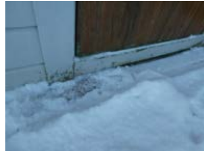
Beslag under dørterskel er ikke etablert.
