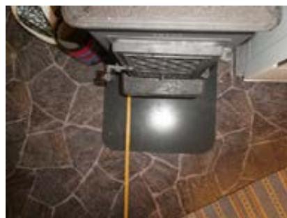
Litt kort avstand til brennbart materiale. Plate under ovn bør ikke være under 30 cm ut fra sotluke.
