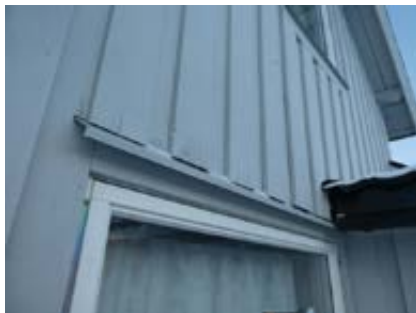
Stedvis en del sprekk på nedre del av kledning
