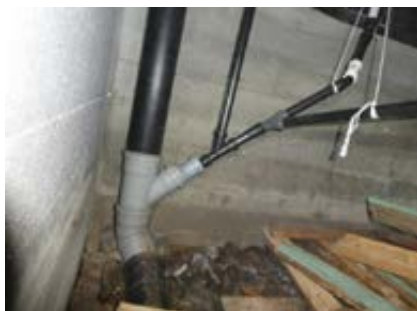
Uegnet materialer og Ikke fagmessig utført
