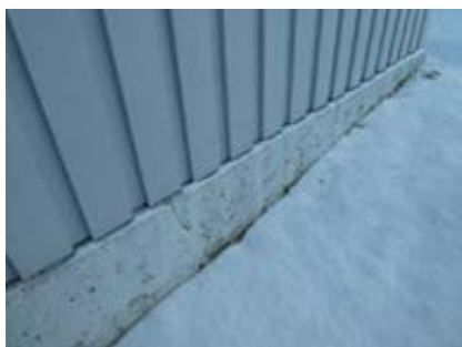
Sprekk i utvendig murpuss
