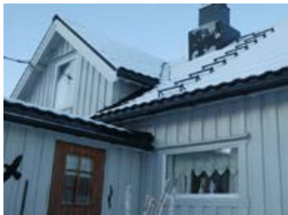
Lakk avskalling på pipebeslag
