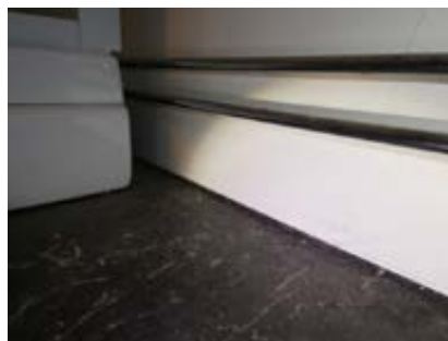
Veggplatene er ikke montert etter monterings anvisning
