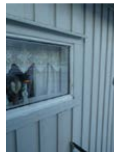
Utvendig tetting ikke helt fagmessig utført
