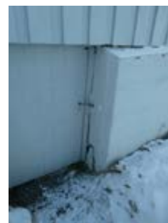
Sprekk i murpuss ved kjellerdør
