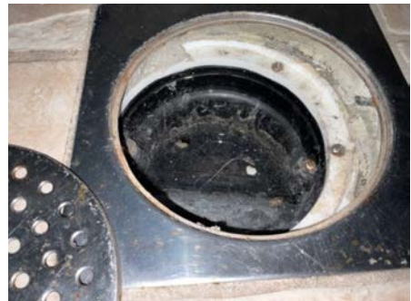
Sluken på gulvet ved vannskap, bereder og vaskemaskin. Synlig membran klemt under klemring i denne sluken.
