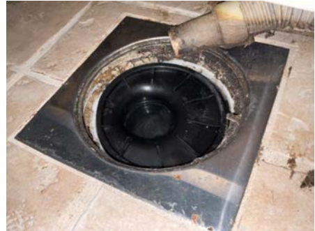
Sluk under dusjkabinett. I
