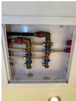
Rørskap i badromshimling med 2 x stoppekraner
