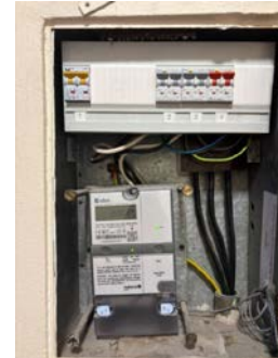
Elskap, plassert i felles trappegang.
