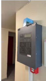
Felles brannvarslingsanlegg i bygget
