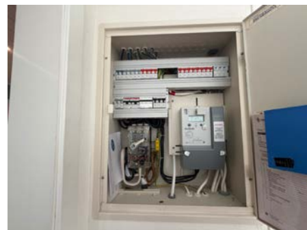
Renovert sikringsskap med automatsikringer.
