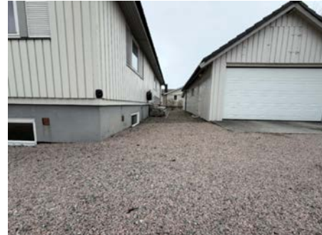
Terreng heller stedvis mot grunnmurene.
