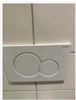
Fuge løsnet mellom flis
