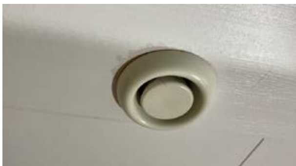
Fuktmerke ved ventil.
