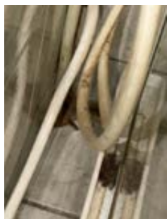
Rørgjennomføring i gulv i våt sone.
