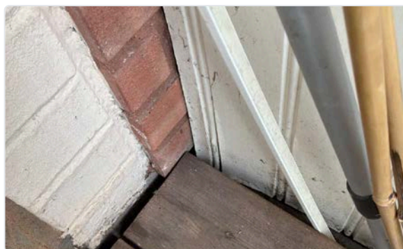
Det er svellinger i panelplater på innsiden.
