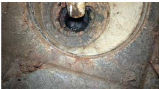
Sluk under dusjkabinett.
