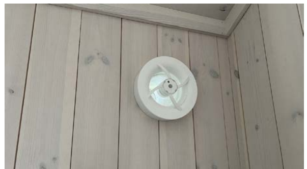
Elektrisk styrt vifte
