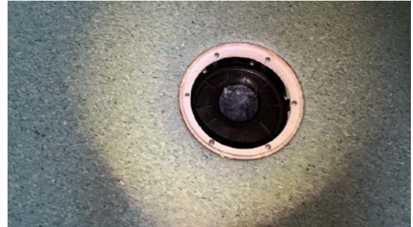
Sluk i dusjsone
