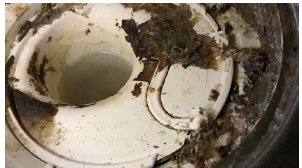
sluk under dusjkabinett
