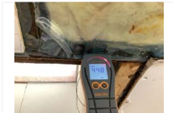
Lekkasje i toalettrom etter lekkasje fra kuppel
