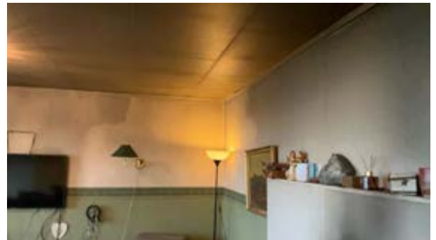
Betydelig nedsoting mot øst
