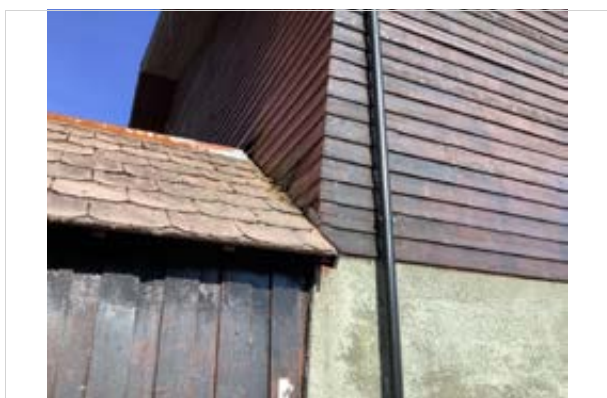
Råteskader i bordkledning
