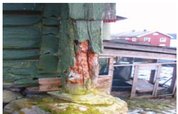
Noe råte og insektangrep på bærende konstruksjoner
