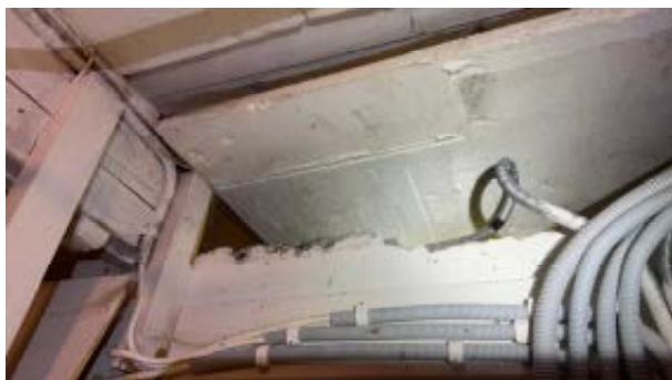
Synlig isopor bør brann-beskyttes
