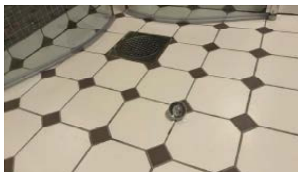
Klinkekule bør trille til sluk
