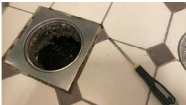
Løs flis ved sluk.
