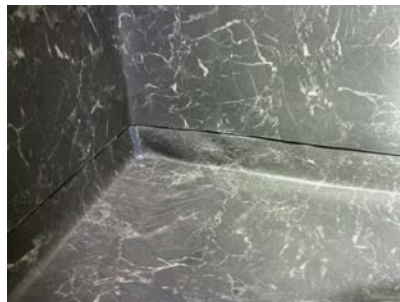
Membran/belegg er løsnet på vegg i dusj-sone.
