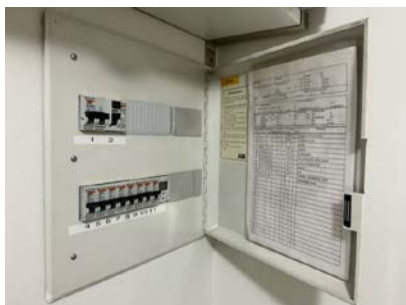
Sikringsskap står i bod.
