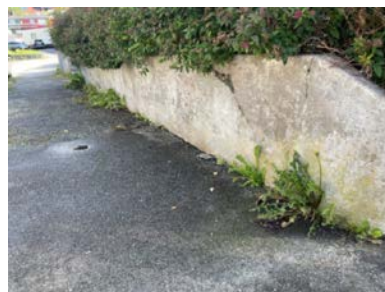
Sprekker i mur mot kommunal vei.
