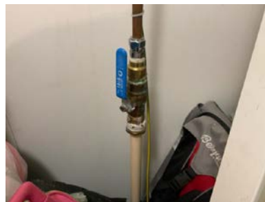
Stoppekrane er funksjonell, men er ikke kontrollert om den stenger 100%.
