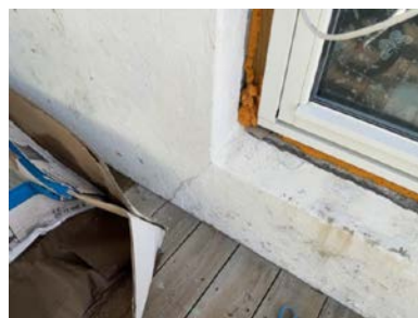
Mindre riss/sprekker i grunnmr.
