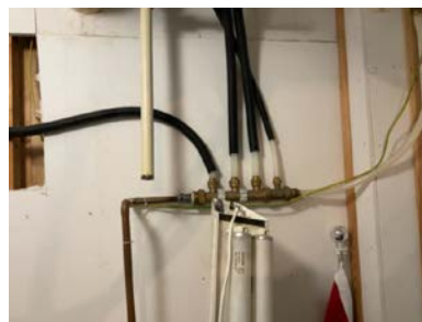
Rør i rør stamme skal være i lukket skap med drenering til rom med sluk. Mangler også endeavslutninger på trekkerør.
