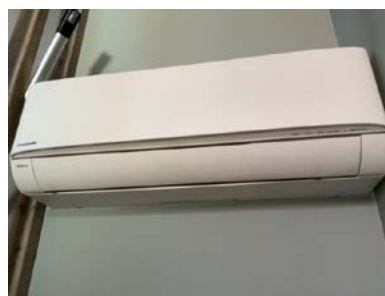
Innvendig luft til luft varmepumpe.
