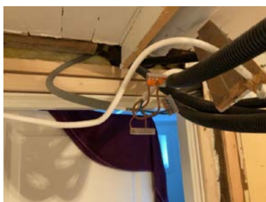
Manglende komplettering av kasse i tak (kjeller).
