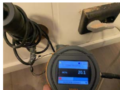
Kontrollmåling på soverom i kjeller viste 20,1 vekt% fukt, som er noe over anbefalte verdier hvor det anbefales under 17 vekt%.
