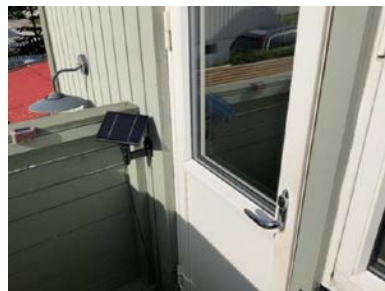
Balkongdør fra soverom 1. Etasje, med defekt låse/vriderfunksjon.
