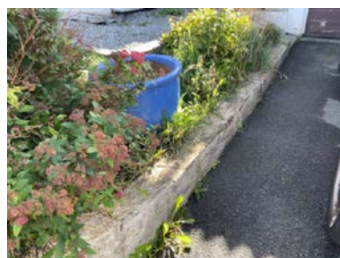
Mindre sprekker i mur.
