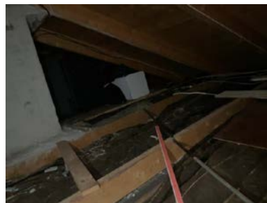
Ikke tilfredsstillende brannvegg/skillemot kaldloft.
