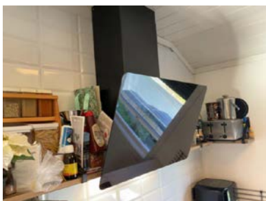
Ventilator på kjøkken-
