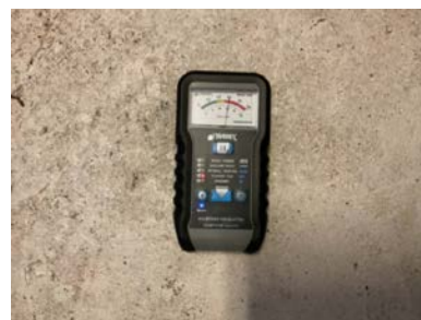
Bruk av fuktindikator på gulv viste forhøyede verdier.
