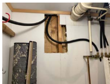
Ikke tilfredsstillende brannvegg mot nabo, åpent bindingsverk uten gipsplater.
