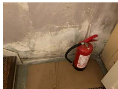
Visuelle tegn på fuktvandring gjennom yttervegg mot terreng ved salt/kalkutslag på innsiden av grunnmur.
