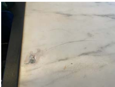
Skader på benkeplate.
