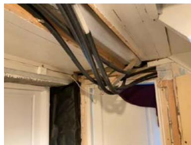
Rørlegging fremstår som ufagmessig utført og mangler tilfredstillende innfestning i kjeller.
