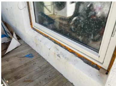
Manglende vannbrett/tetting på vinduer i kjeller.
