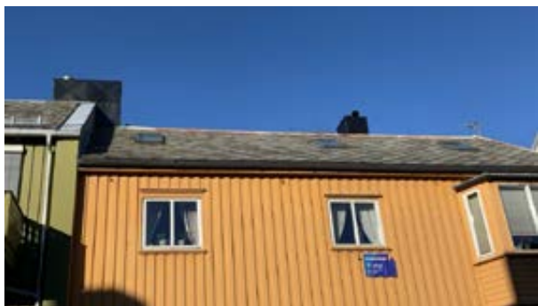
Manglende snøfanger mot offentlig fortau
