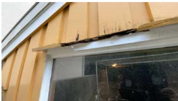
Råteskader på vannbrett over vindu.
