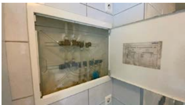
Rør i rør sentral.
