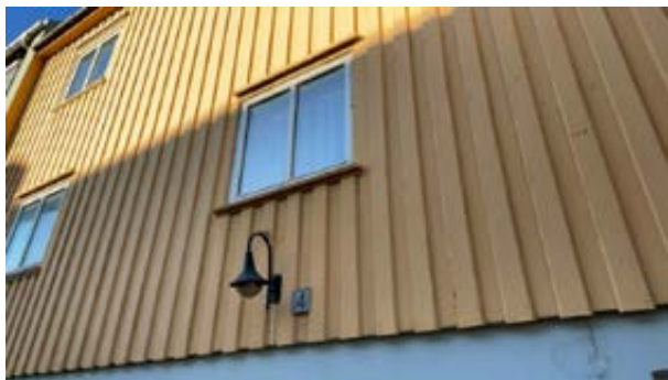
Vindu uten beslag/lufting.
