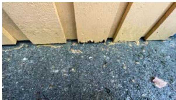
Stedvis råteskadet kledning.
