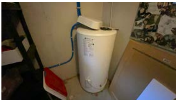
Varmtvannsbereder i bod sokkeletasje.
