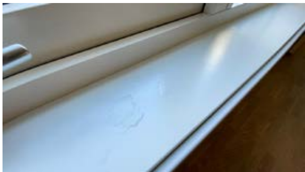
Svell/fuktskader på utforing.
