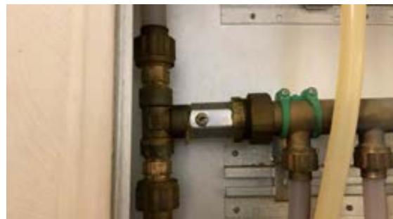
Avstegningsventil i rørskapet.
