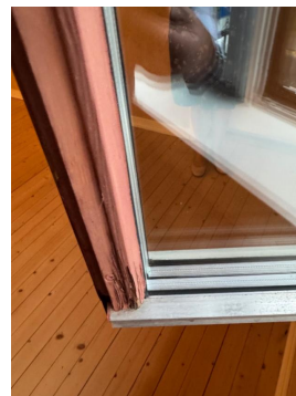
Utvendige vinduskarmer med sprekker i treverket.
