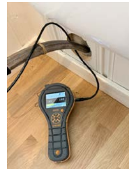
Kjellerstue: Målt 19 vektprosent fuktinnhold i bunnsvill.
